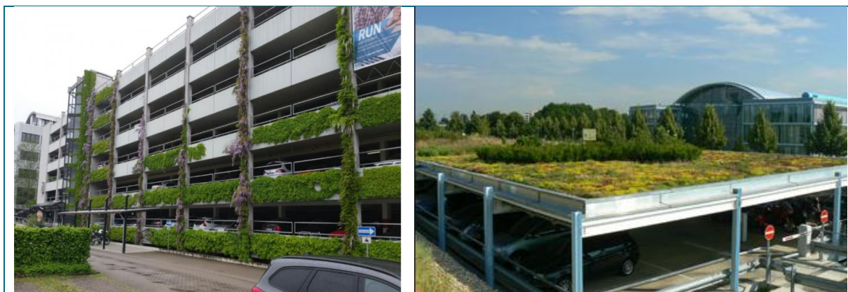
Parkhausbegrünung mit Wildem Wein und Blauregen (links), intensive und extensive Dachbegrünung eines Parkhauses (rechts); Internetquelle: www.brandmeier.de & www.soll-galabau.de
